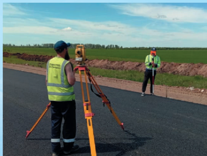
Строительный контроль на автодороге «Алексеевское – Альметьевск» в составе платной автодороги «Шали – Бавлы»
